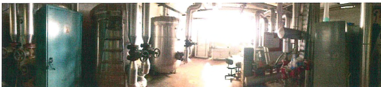
Figura – Centrale di smistamento e serbatoi di accumulo.
