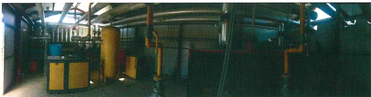
Figura – Centrale termica
