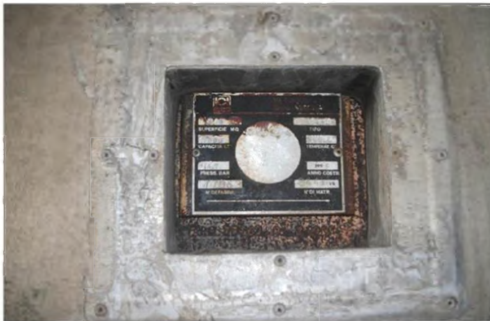
FIGURA 4- TARGA IDENTIFICATIVA GENERATORE DI CALORE AUSILIARIO IN SERVIZIO DI TELE-RISCALDAMENTO
