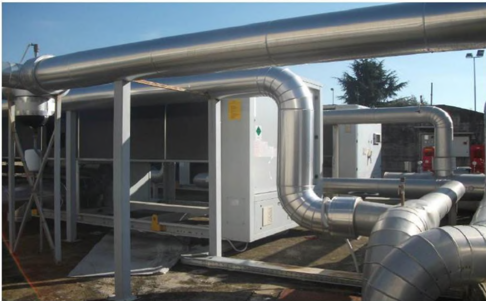
FIGURA 6 - GRUPPI DI REFRIGERAZIONE A SERVIZIO DELLA RETE DI TELE-RAFFREDDAMENTO (1 DI 2)
