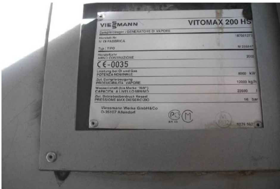
FIGURA 3- TARGA IDENTIFICATIVA GENERATORE DI CALORE AUSILIARIO IN SERVIZIO DI TELE-RISCALDAMENTO
