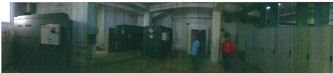
Figura – Cabina di trasformazione.
