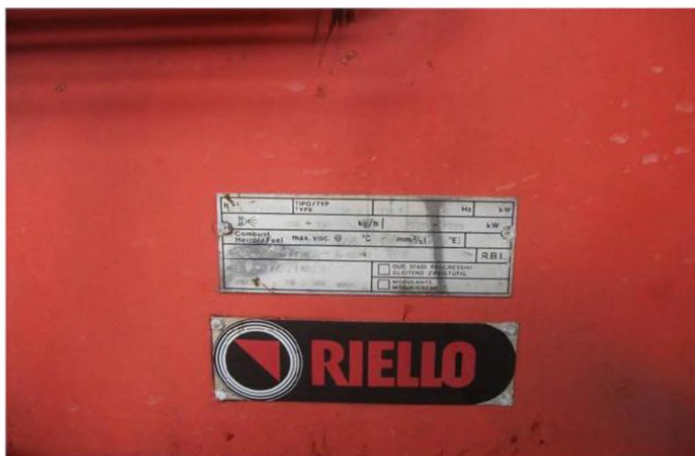
FIGURA 5 – TARGA IDENTIFICATIVA BRUCIATORE A SERVIZIO GENERATORE DI CALORE AUSILIARIO IN SERVIZIO DI TELE-RISCALDAMENTO
