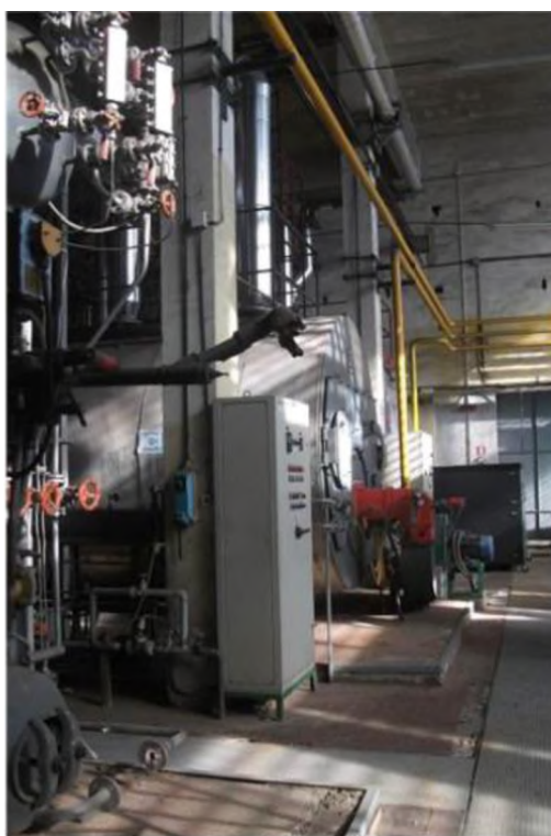
FIGURA 1- CENTRALE TERMICA DI TELE-RISCALDAMENTO
