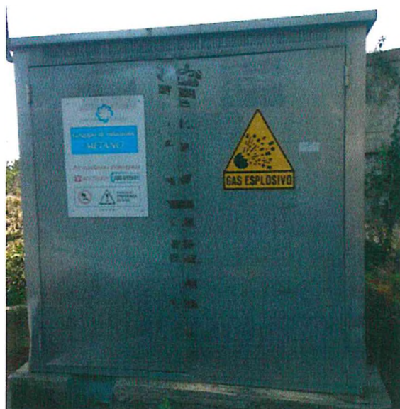
Figura – Cabina per la fornitura di gas metano.
