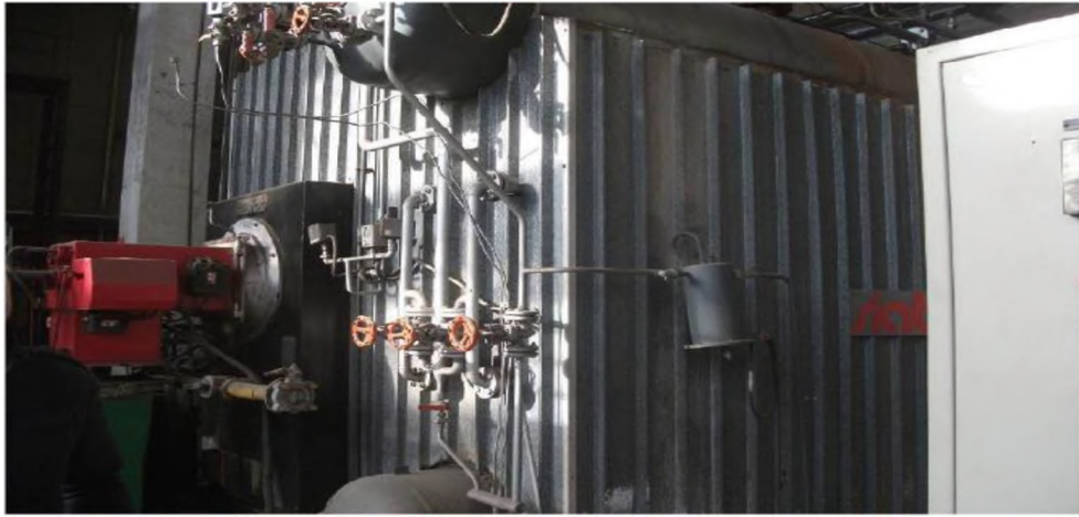
FIGURA 2 – GENERATORE DI CALORE NON IN SERVIZIO E DA DISMETTERE
